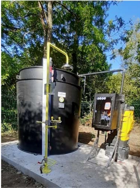
Bois d'Arcy , Installation d'une station de traitement de l'hydrogène sulfuré (H 2 S) au PR Robespierre :
