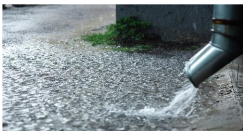
Figure 5: Rejet de gouttière de toiture
