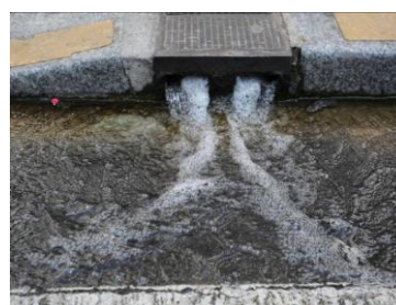
Figure 6 : avaloir de rue
