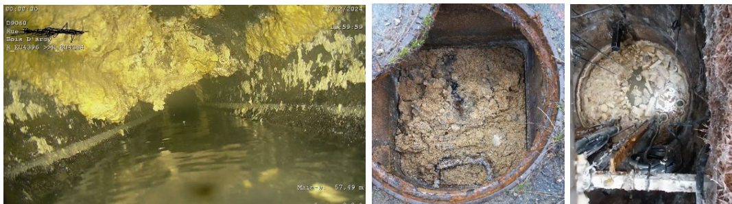
Graisse en canalisation, en regard de visite, et en poste de pompage.
